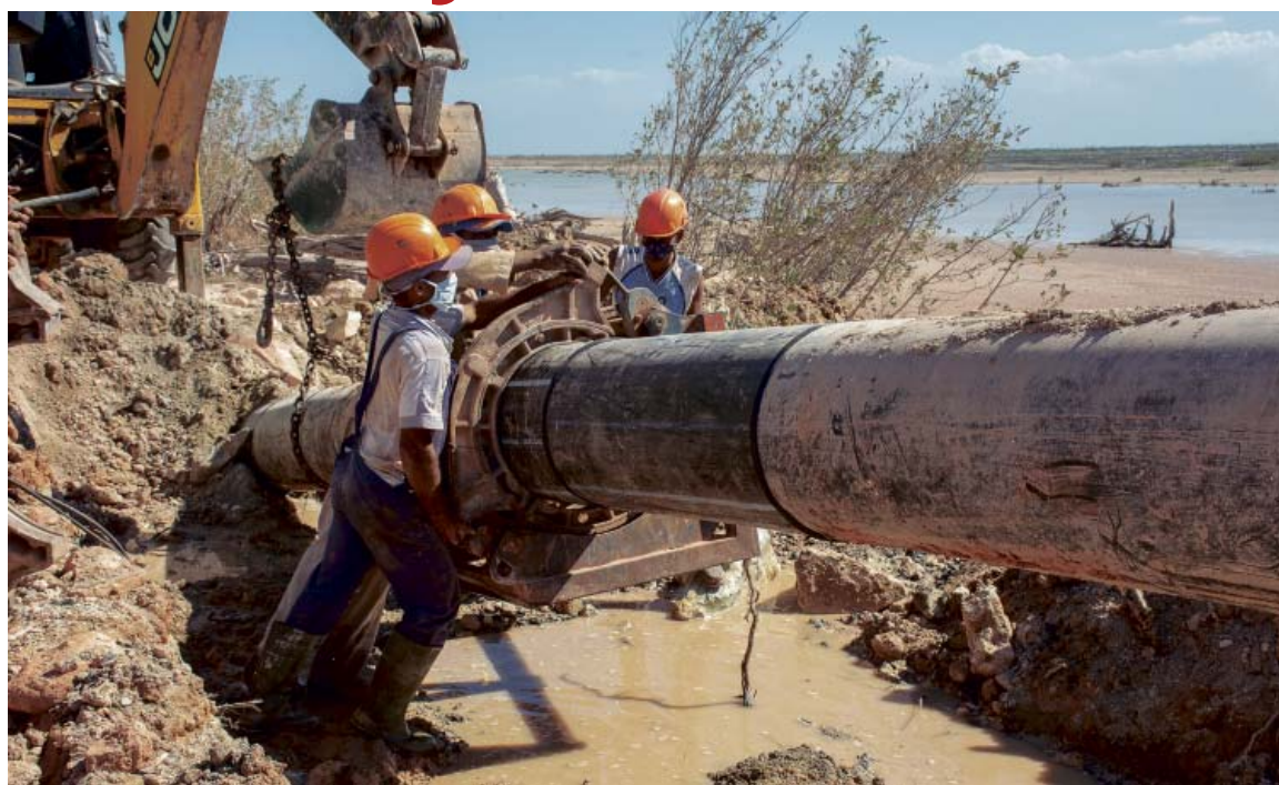
Desde Imías en Sierra de Cubitas hasta Cayo Cruz, llegó el agua dulce en el 2020 a través de 89 kilómetros de conductora de 500 milímetros de diámetro.
