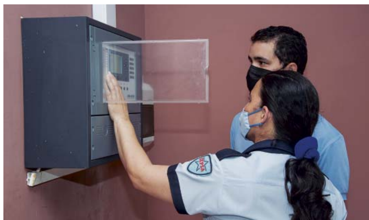
En ETECSA cuentan con equipamiento automático para la detección temprana de incendios.
