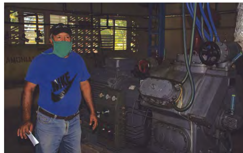
Para la conservación de los alimentos en las neveras resulta vital la sala de máquinas de refrigeración, instalada junto a la de caldera, a un costo de cerca de medio millón de pesos, cuando en el 2018 Florida acogió el acto provincial por el 26 de Julio.
