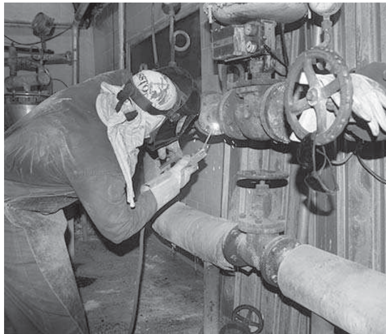
Un buen ejemplo de la colaboración entre las empresas es el servicio que presta ServiQuímica Nuevitas a la Empresa Láctea; ellos, con sus soldaduras especializadas asumen el montaje de las tuberías de vapor.
