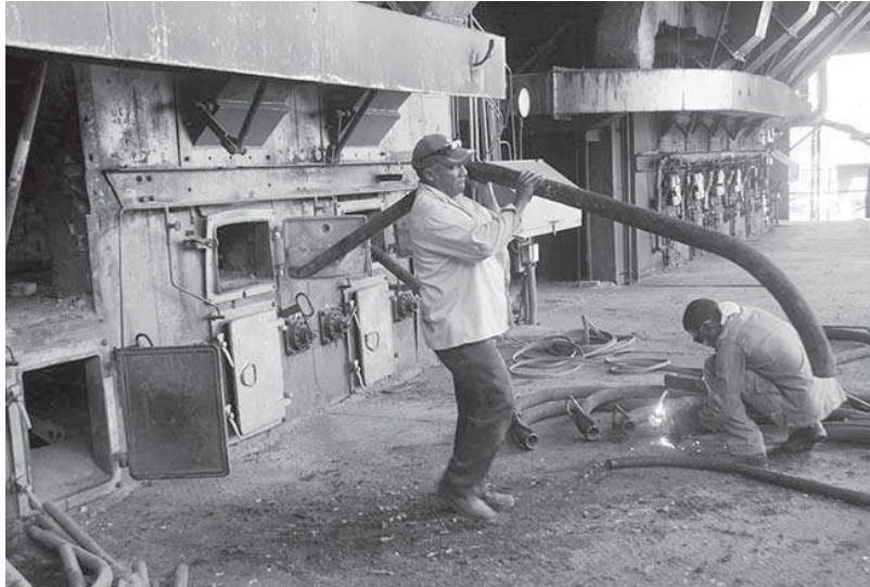
Especialistas de la ZETI se apresuran para poner de alta la caldera que debía estar de reserva.
